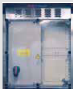
Eingangsseitiger Trennschalter zum Freischalten des Abwärtstrafo
