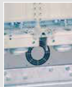
Doppelkabelverschluss mit Kabelschellen, 400V Schaltraum zwangsbelüftet
