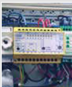
Isolationsüberwachung der 1.000V Strecke, Traforaum zwangsbelüftet
